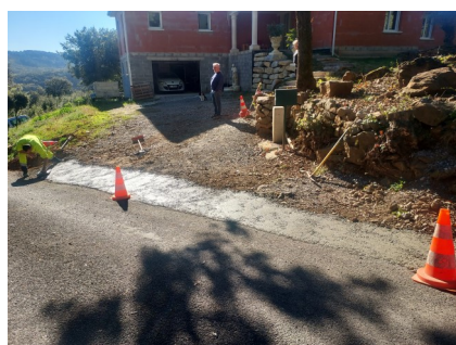
Reprise de la voirie très abimée
