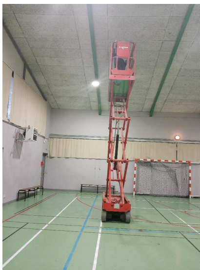
Changement des blocs secours de la salle polyvalente et réparation d'une plaque
