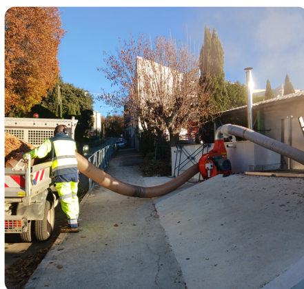
REPLISSAGE SILO CHAUDIÈRE DE LA SALLE POLYVALENTE
